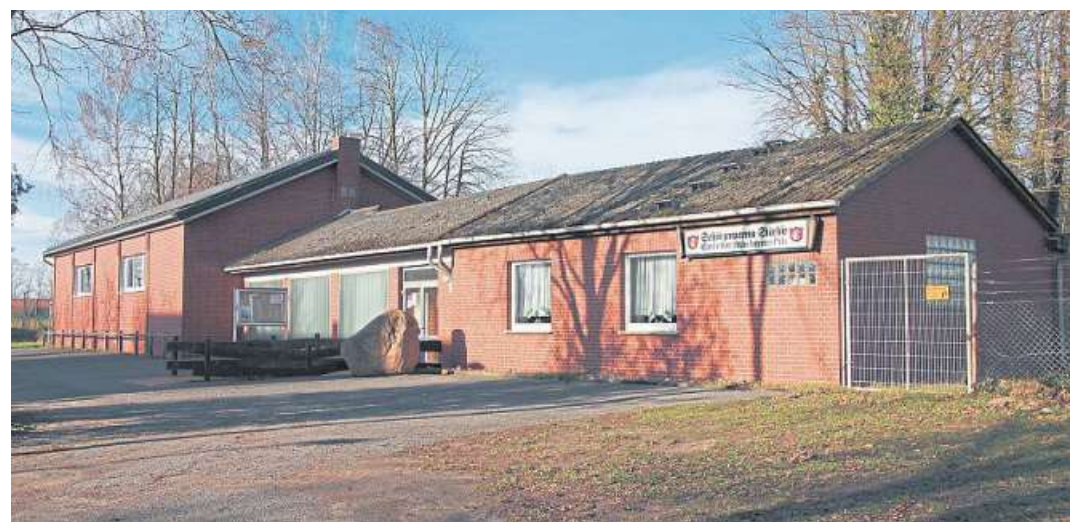
Die Sanierung des Daches vom Schützenhaus in Stöckse wurde erneut verschoben. Bei Regen tropft es auf den Gewehrshrank.
