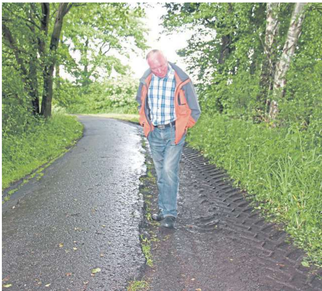
Bürgermeister Dieter Vehrenkamp begutachtet Schäden auf dem Jägerdamm.
